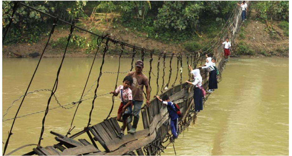
Abb. 20 | Die Fußgängerbrücke wurde zerstört. Auf ihrem Schulweg müssen diese Kinder den Fluss trotzdem überqueren.
