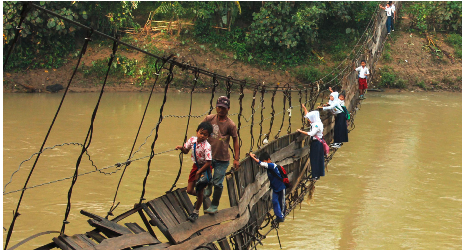
Abb. 20 | Die Fußgängerbrücke wurde zerstört. Auf ihrem Schulweg müssen diese Kinder den Fluss trotzdem überqueren.
